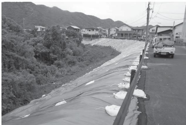
宅地造成地（花園台）の被害状況
