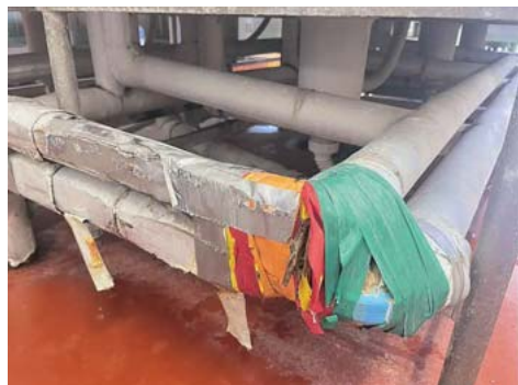
様々な設備の劣化が進んでいる
