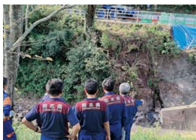
花園台の再度崩落した通学路 本年度までに復旧を
