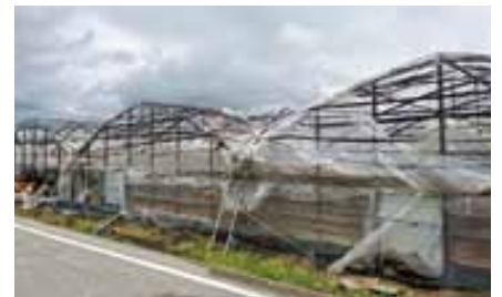
ビニールハウスの破損
