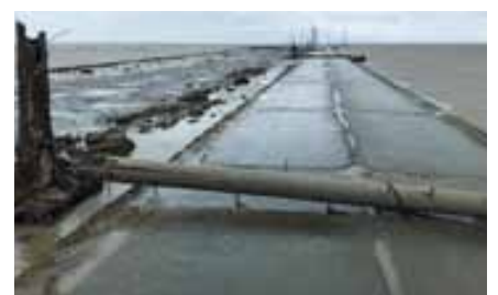
長部田海床路の電柱倒壊
