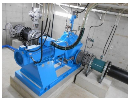
小水力発電（戸島送水場）
