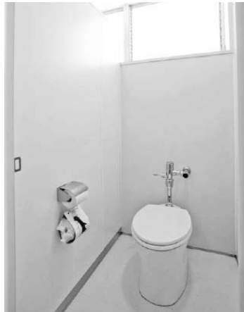
節水型の洋式便器(網津小学校)
