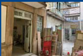
湯徳章故居 弁護士時代の事務所兼住居。2022年、民間団体の台南市文化資産保護協会が購入。現在、記念館としてリニューアルするため、整備工事が進められています。
