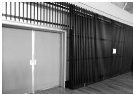
省エネの冷暖房設備
