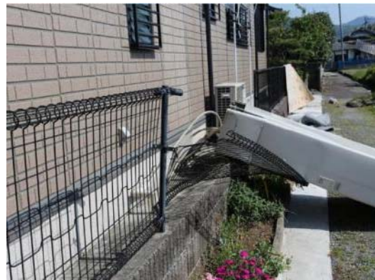
図 給湯施設の転倒
