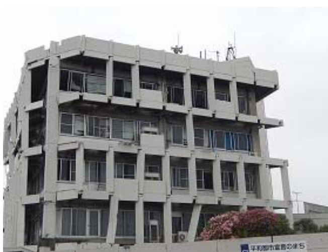
図 平成28年熊本地震による被害（本庁舎）
