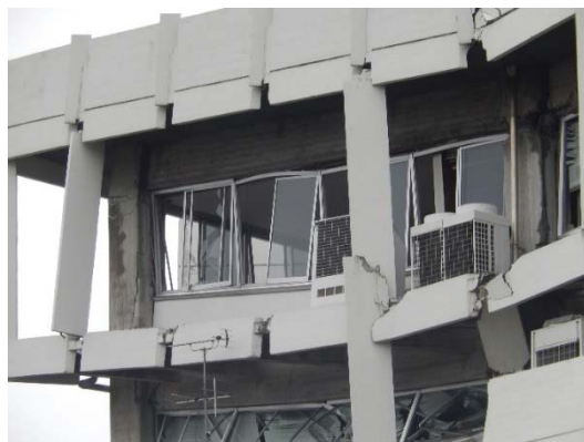
図 庁舎棟の局部崩壊
