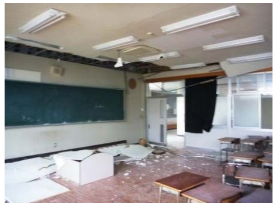
図 天井の脱落（校舎）
