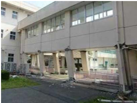
図 渡り廊下の倒壊（校舎）
