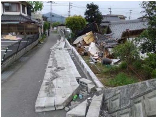
図 ブロック塀の倒壊
