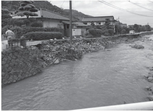
6月豪雨・網津川護岸崩壊（割井川地区）
