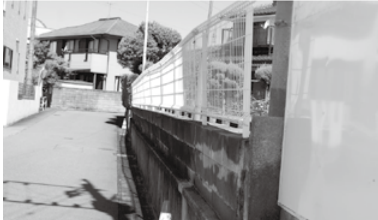
危険表示、傾くブロック塀とフェンス
