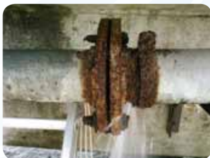
水道管の老朽化による漏水
