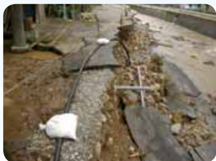
大雨災害による水道管の破損
