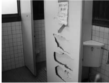
住吉海岸公園トイレ壁（パーテーション）の破損状況
