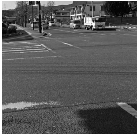
消えかけている横断歩道と外側線(南段原セブンイレブン前)
