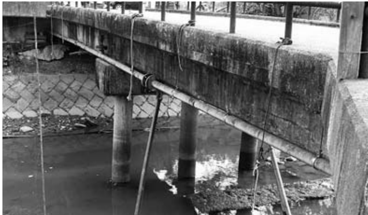
剥離・鉄筋が露出した橋梁
