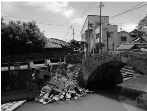
←船場橋被災状況
