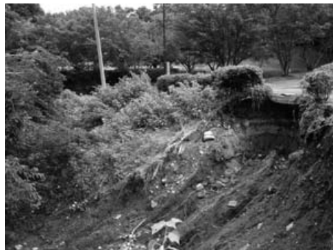
←宇土城跡(西岡台)崩落箇所
