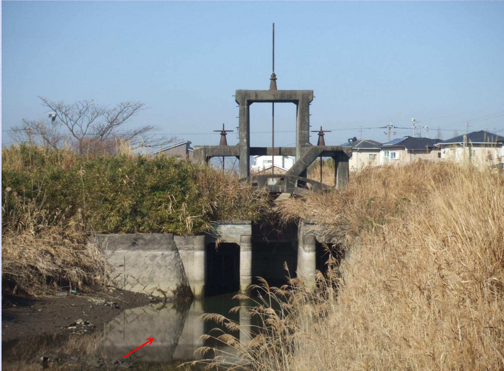
⑤ 大きく河積を阻害している馬之瀬樋門
