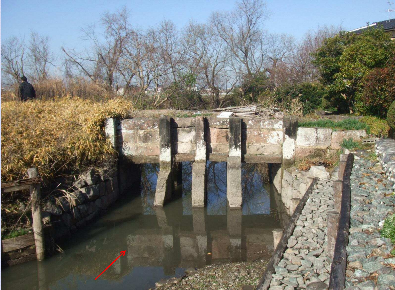
④ 大きく河積を阻害している松原水門
