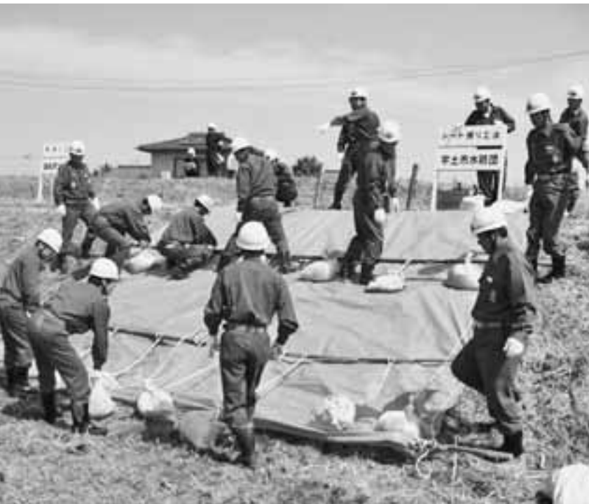
市消防団幹部による緑川水防演習時「シート張り工法」の訓練
