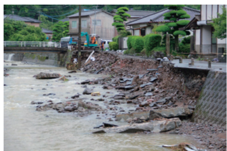
護岸崩壊(割井川区)
