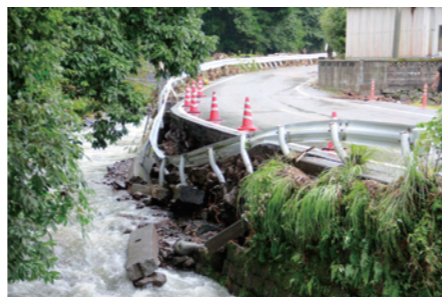
護岸崩壊(網津川)
