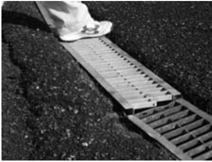
側溝蓋の破損
