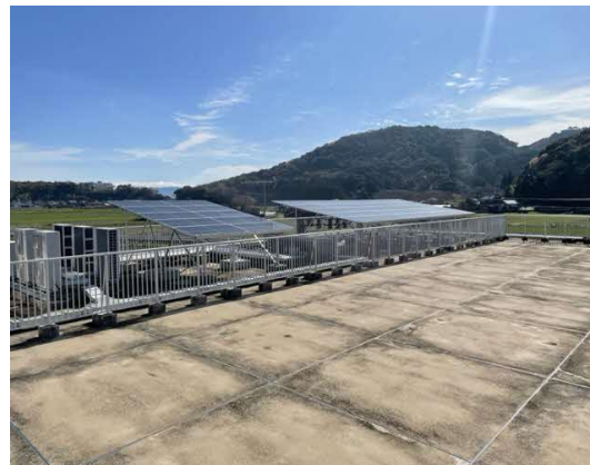
網津防災センター太陽光発電パネル
