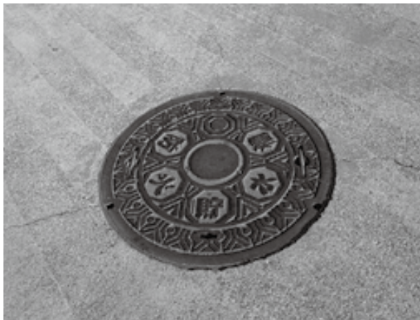
災害に強い防火貯水槽
