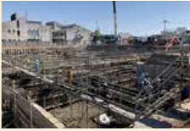
基礎の工事や免震ピットの工事 令和3年7月～12月 免震装置の設置 令和4年1月～3月
