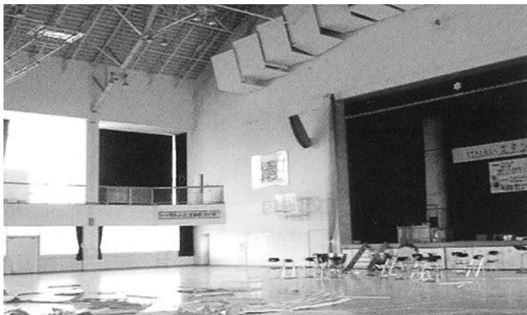
地震によって脱落した天井材(文科省ガイドブックより)
