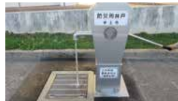
走潟小体育館前に設置された防災井戸
