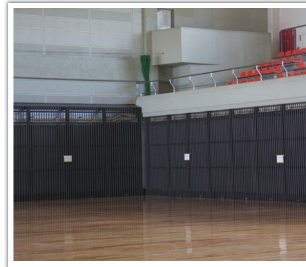
●市民体育館1階アリーナの壁一面に導入された除湿型放射システムエコウィン
