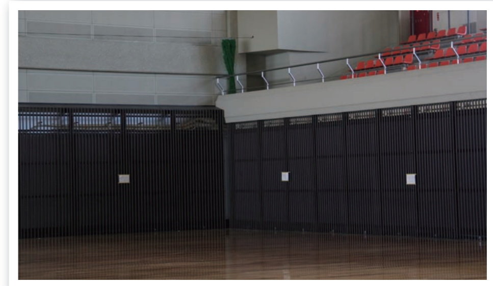
●市民体育館1階アリーナの壁一面に導入された、除湿型放射システムエコウィン
