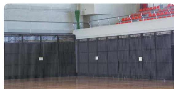
●新しくなった市民体育館。除湿型放射システム「エコウィン」という冷暖房施設を1階アリーナの壁一面に導入
