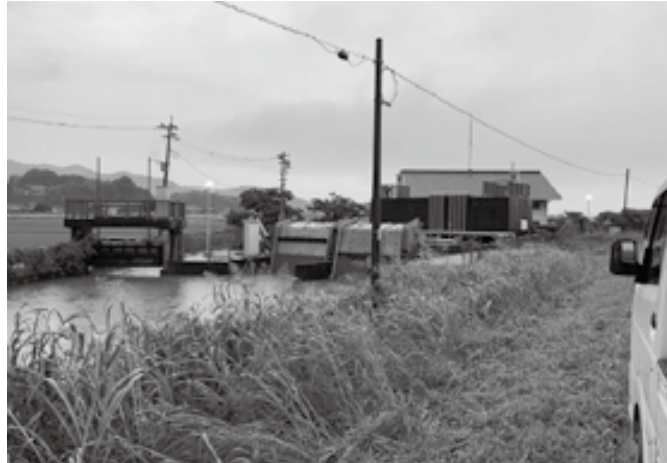
水田の冠水を防ぐため稼働中の排水施設
