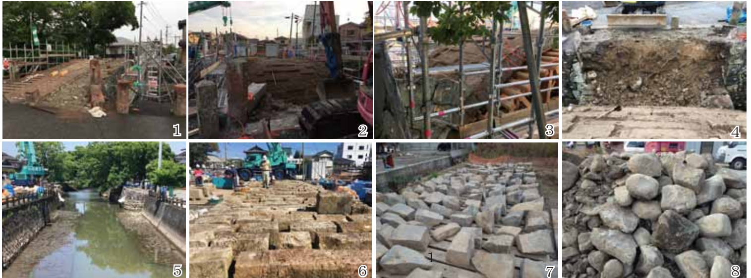
船場橋解体工事状況（1 橋面・欄干の撤去，2～4 壁石・中詰め材等の撤去，5 解体完了状況，6 輪石保管状況，7 壁石保管状況，8 中詰め材保管状況）
